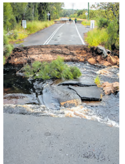
Der viele Regen in Australien spülte sogar eine Straße weg. Foto: dpa
