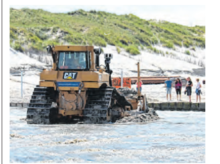
Die Sturmflut hat viel Sand abgetragen, und die Sanddünen beschädigt. Foto: Volker Bartels, dpa
