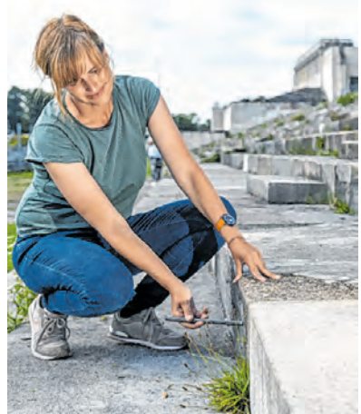
Heike Wolter kontrolliert Natursteine an der Zeppelintribüne in Nürnberg auf Schäden. Foto: Daniel Karmann, dpa
