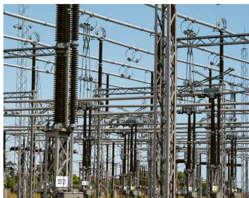
Wie in Drehkreuzen: Umspannwerke verteilen Strom weiter. Foto: Grubitzsch, dpa
